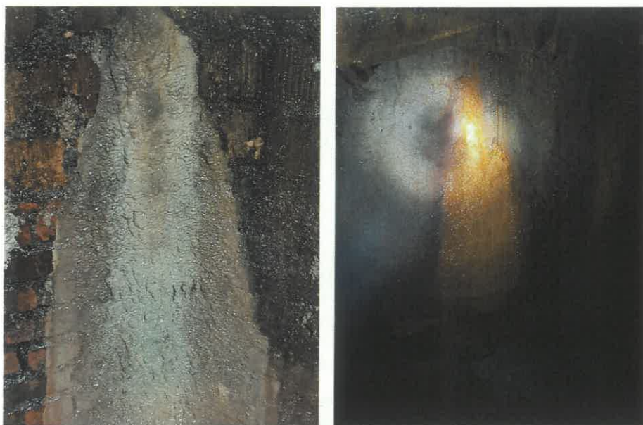
Fot. 43. – Luneta – nieszczelności i przecieki przez ściany lunety podsadzkowej – zdjęcia wykonane w 2023 r.
