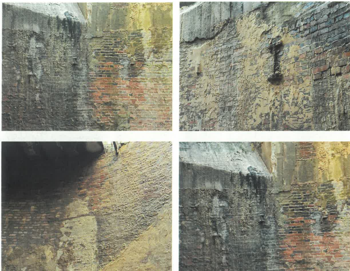
Fot. 8. Widok na ściany zbiornika piasku wykonane w 2025 r. Miejscowe uszkodzenia otuliny elementów żelbetowych zbiornika oraz korozja zbrojenia. Korozja stalowych elementów kotwiących zbiornika. Braki w spoinowaniu okładziny z cegieł klinkierowych. Ogólny stan okładziny klinkierowej dostateczny. Użytkownik nie wykonał zaleceń wskazanych w ekspertyzie z 2023r. Obiekt wymaga remontu.
