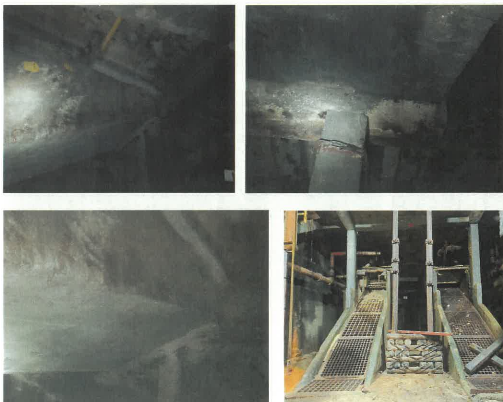
Fot. 19. Zsuwnia pomiędzy poziomem -52,3m i poziomem -57,3m – zdjęcie wykonane w 2025r., korozja prętów zbrojeniowych w belkach podpierających zsuwnie. Płyta żelbetowa zsuwni została zabezpieczona przez Użytkownika. Od czasu wykonywania ekspertyzy w 2023r. wykonana otulina zewnętrzna nie wykazuje śladów korozyjnych, odspojień i wykruszeń materiału naprawczego. Belka podpierająca zsuwnię wymaga przeprowadzenia remontu.
