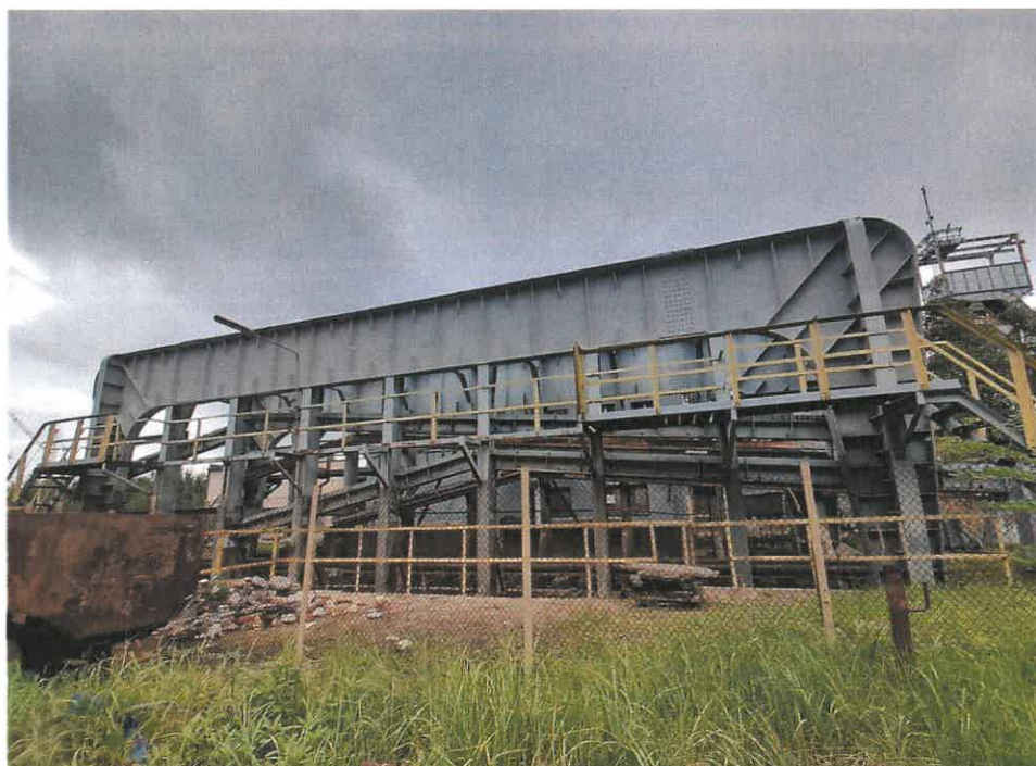
Fot. 4. Widok na most rozładowniczy i konstrukcję zabezpieczającą wlot zbiornika – zdjęcie wykonane w 2023 r. Użytkownik zabezpieczył wlot do zbiornika w sposób trwały. Ogrodzenie zabezpiecza wlot do zbiornika przed dostępem osób postronnych. Nie zapewnia jednak bezpiecznego użytkowania obiektu. Aby obiekt mógł w dalszym ciągu być bezpiecznie użytkowany, konieczne jest pilne przeprowadzenie remontu stalowej konstrukcji wsporczej wlotu i przekrycia zbiornika.
