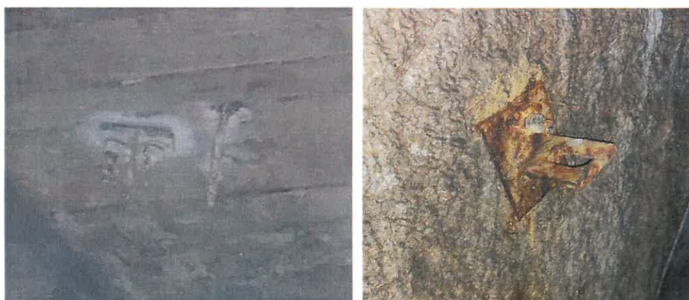
Fot. 35. Korodujące elementy technologiczne – zdjęcie wykonano w 2025 r. Korozja elementów technologicznych znaczna. Lokalnie poszczególne elementy zostały zabezpieczone przed korozją. Zabezpieczenie elementów technologicznych ze względu na agresywne warunki użytkowania nie było skuteczne. Ulegają one w szybkim tempie korozji i wpływają na destrukcyjnie na elementy konstrukcyjne.
