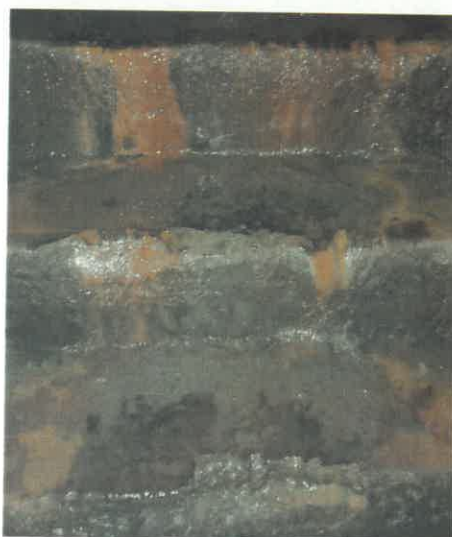
Fot. 37. Lokalne ubytki w stopniach schodowych łączących stropy poniżej zbiornika podsadzkiowego – zdjęcie wykonane w 2025r..
