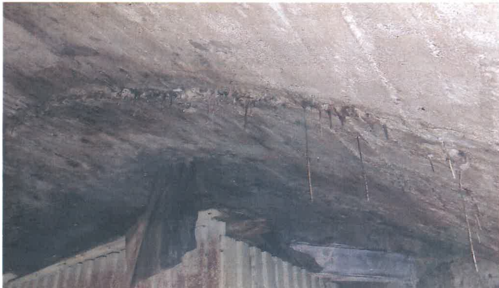
Fot. 17. Ściany pomieszczeń poniżej zbiornika kamienia i piasku – wykwit solny powstałe na skutek oddziaływania wody wraz z zawartymi w niej związkami na ściany obiektu – zdjęcie wykonane w 2025r. Znaczna ilość wykwitów krystalizujących się na ścianach i stropach w części podziemnej budynku. Lokalnie Użytkownik usuwa nacieki i wykwit solny, jednakże prace te nie są prowadzone regularnie. Sukcesywne usuwanie wykwitów i nacieków jest rozwiązaniem wyłącznie doraźnym stosowanym do czasu wykonania kompleksowego remontu ścian obiektu. Beton należy niezwłocznie zabezpieczyć przed działaniem agresywnych wód gruntowych (od zewnątrz) jak i wód technologicznych (od wewnątrz).
