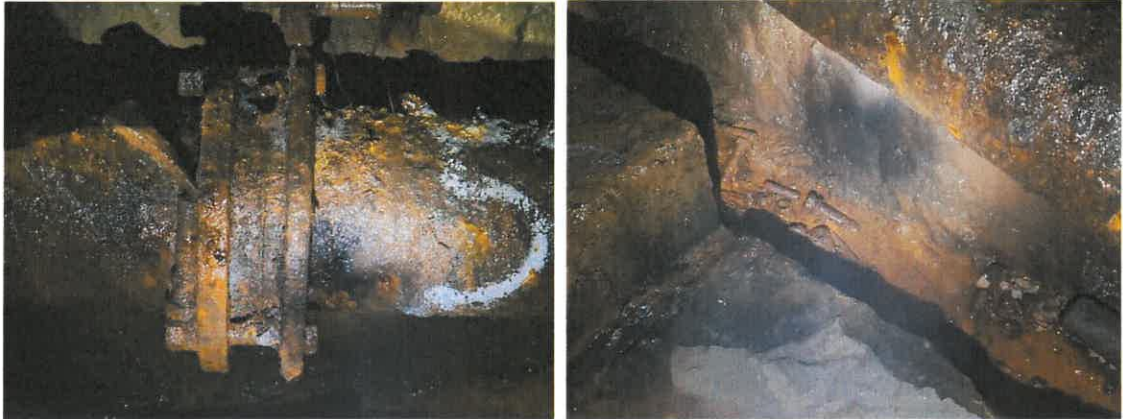
Fot. 45. Luneta – znaczna korozja i braki śrubowe w kołnierzach rurociągów – zdjęcie wykonane w 2023 r.
