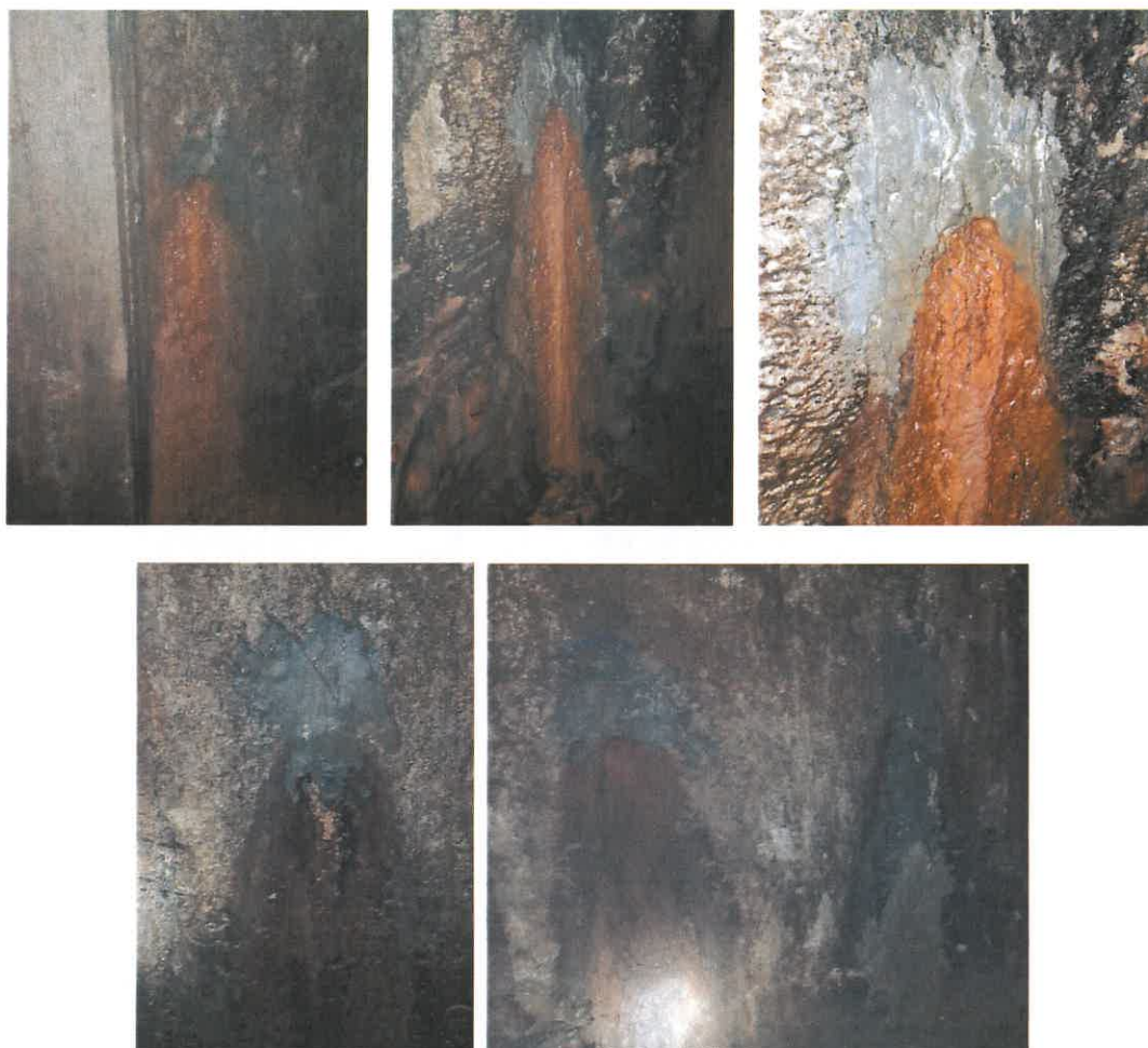
Fot. 27. Nieszczelności i przecieki ścian zbiornika podsadzowego – zdjęcie wykonano w 2025 r. W 2023r. Użytkownik obiektu wykonał miejscowe, doraźne naprawy nieszczelności w ścianach zbiornika podsadzowego. Część napraw okazała się nieskuteczna, a zaprawa naprawcza wykruszyła się pod wpływem napierającej wody gruntowej. Lokalnie pojawiają się nowe przecieki, co może świadczyć o braku jednorodności struktury betonu tworzącego ścianę. Należy wykonać kompleksową naprawę ścian pod kątem ich szczelności. Oddziaływanie wody wraz ze związkami chemicznymi na pręty zbrojeniowe ścian spowoduje ich korozję i oraz sukcesywne pogarszanie się stanu obiektu.
