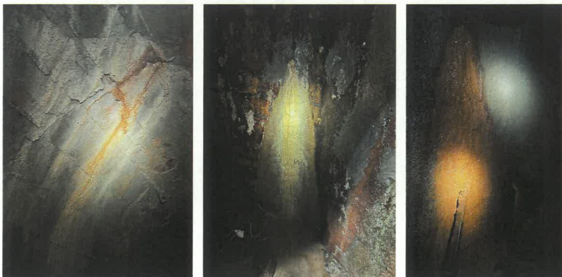
Fot. 44. Luneta - nieszczelności i przecieki ścian lunety podsadzkowej – zdjęcie wykonano w 2025 r. W 2023r. Użytkownik obiektu wykonał miejscowe, doraźne naprawy nieszczelności w ścianach lunety podsadzkowej. Część napraw okazała się nieskuteczna, a zaprawa naprawcza wykruszyła się pod wpływem napierającej wody gruntowej. Lokalnie pojawiają się nowe przecieki, co może świadczyć o braku jednorodności struktury betonu tworzącego ścianę. Należy wykonać kompleksową naprawę ścian pod kątem ich szczelności.
