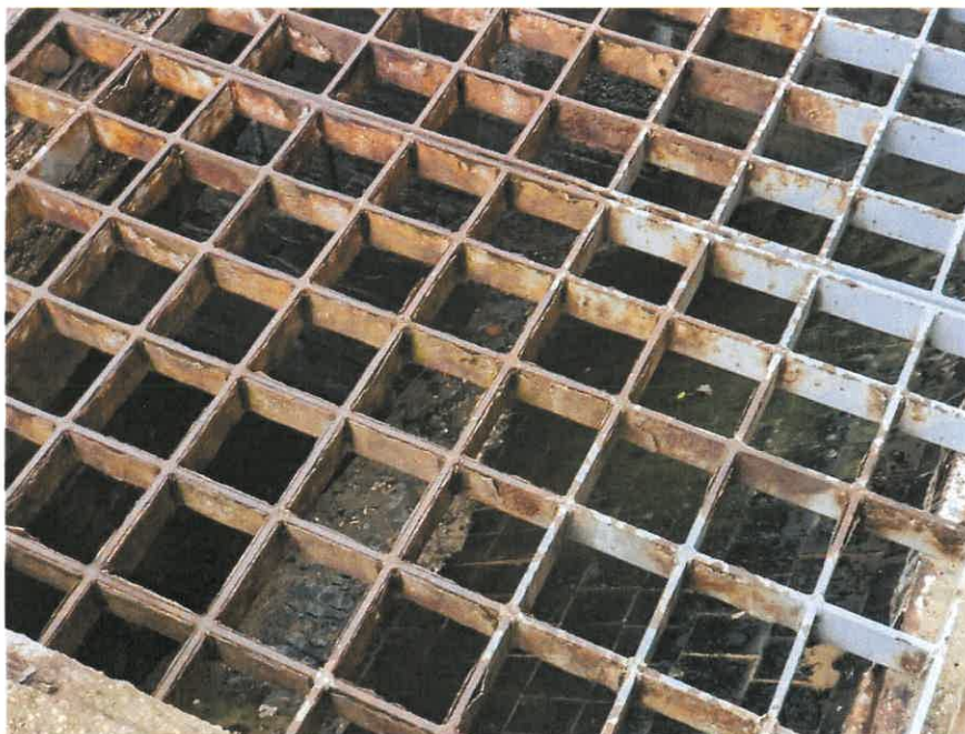
ZBIORNIK PODSADZKOWY - OBIEKT 2.c.10 - KRATA ZABEZPIEZAJĄCA NAD ZBIORNIKIEM
