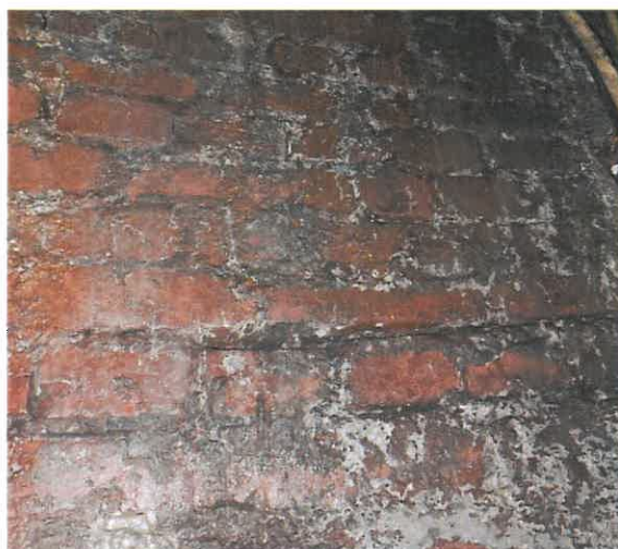
Fot. 38. Lokalne ubytki w materiale ceglanym i spoinowaniu ścian murowanych – zdjęcie wykonane w 2025r.
