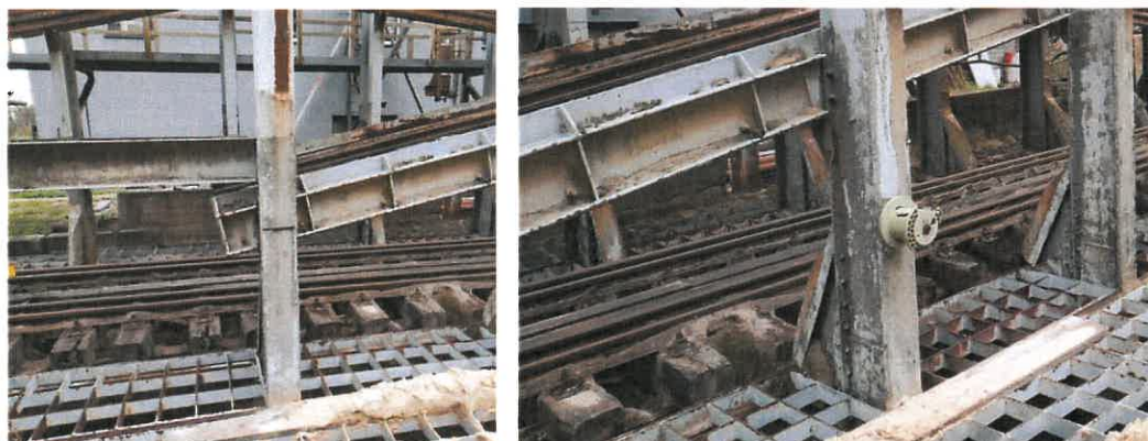
Fot. 2. Widok na kratę przykrywającą wlot zbiornika – zdjęcie wykonano w październiku 2025r. W dalszym ciągu fragmenty krawędzi obmurza są uszkodzone, krata zabezpieczająca – korozja znaczna.
