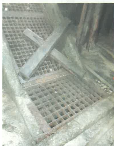
Fot. 33. Strop poziom -57,3m – Korozja krat zabezpieczających otwory lejów podsadzkowych – zdjęcie wykonane w 2025 r. Zalecana wymiana krat zabezpieczających lejów podsadzkowych nie została wykonana przez Użytkownika. Dodatkowo należy wykonać wymianę krat zabezpieczających na poz. -52,3m i -57,3m.
