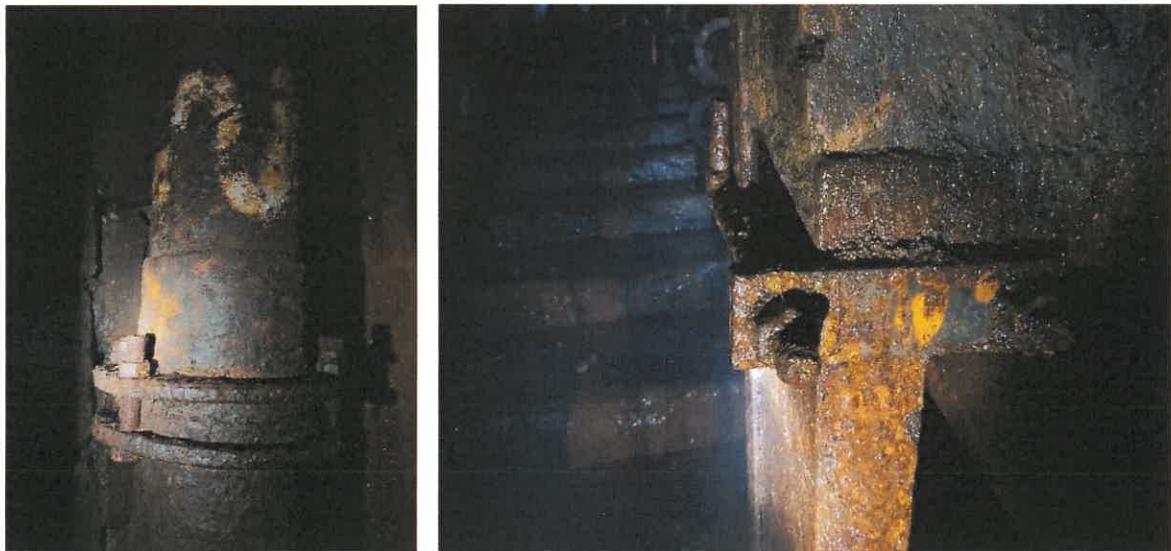
Fot. 46. Luneta - znaczna korozja stalowych elementów technologicznych – zdjęcie wykonane w 2025 r. Użytkownik nie wykonuje bieżących napraw i zabezpieczenia elementów technologicznych. Wykazują one znaczną korozję, która się sukcesywnie pogłębia i stanowi źródło korozji dla innych elementów konstrukcyjnych. Lokalna deformacja śrub w kołnierzach rurociągów. Należy wykonać przegląd instalacji pod kątem konieczności wykonania prac konserwacyjnych.
