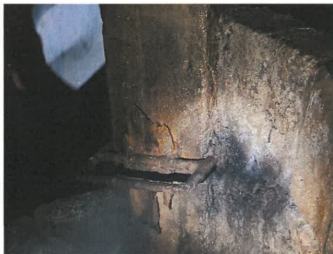
Fot. 39. Luneta – znaczna korozja stalowych elementów drabiny zejściowej do lunety – zdjęcie wykonane w 2023r.
